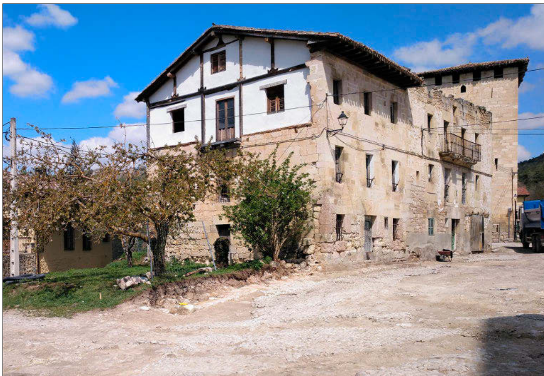
La conocida como Casa Quemada de Valpuesta tendrá que ser rehabilitada y habrá que recuperar su entorno. ECB
